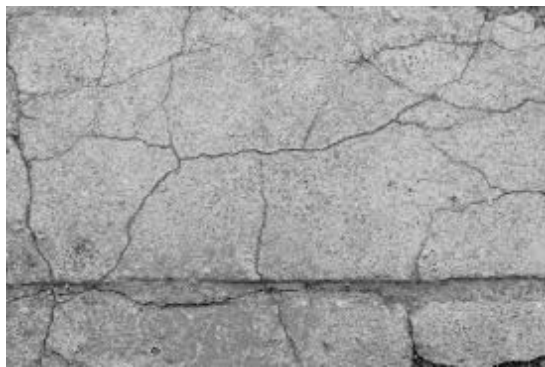
Obr. 1 – Prejav technologických trhlín [5]
